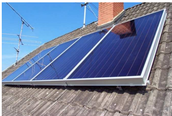
Obr 3.1: Solárny panel na streche
